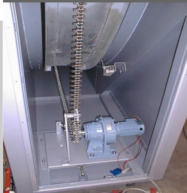
Figura 10 - Il rotore contenente le zeoliti è mantenuto in continua rotazione da un sistema a catena e motoriduttore facilmente ispezionabile dall'esterno.
