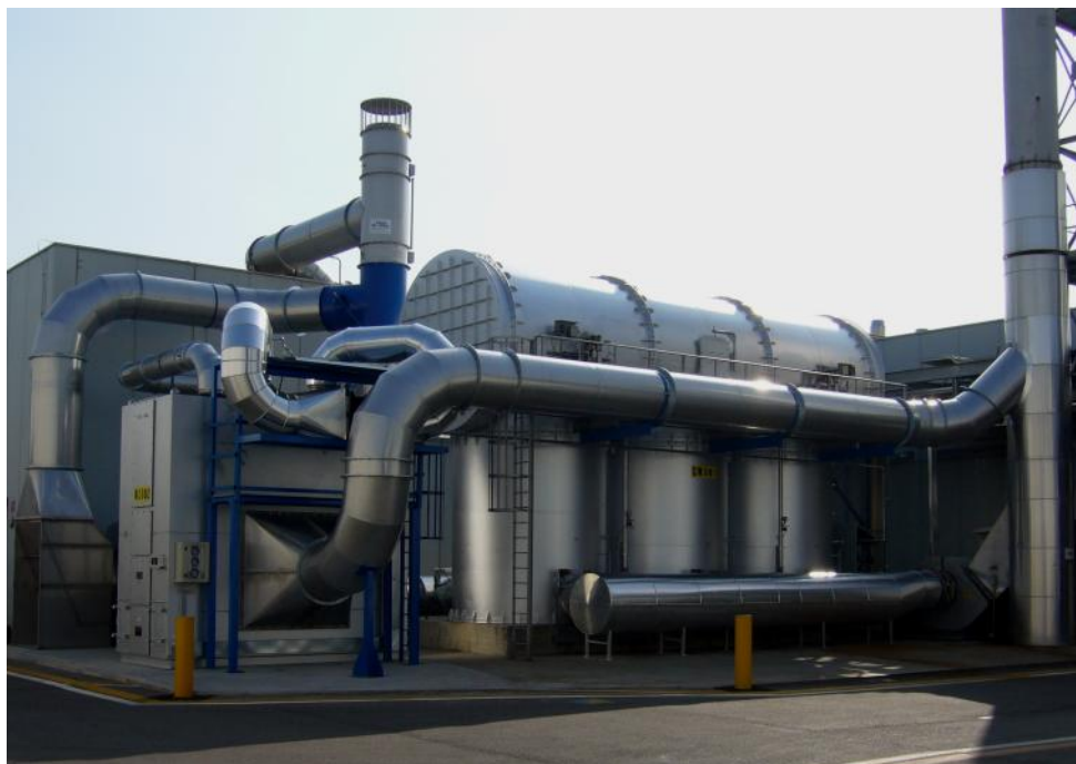
Figura 1 - Impianto per abbattimento solventi da fabbricazione vernici, formato da combustore rigenerativo (RTO) a tre camere e rotoconcentratore a zeoliti (a sin. nella foto).
