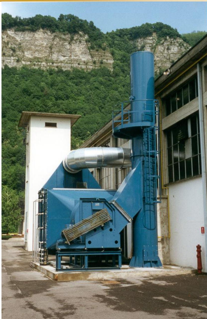
Depuratore M91 installato presso la ditta Cold Forging (Calolziocorte)
