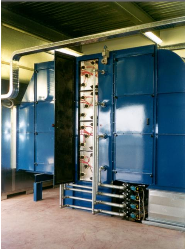
Uno dei tre depuratori M91 installati presso gli stabilimenti SFS SAASBA (Pordenone)
