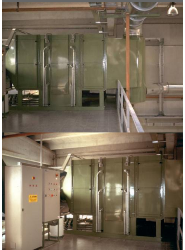
Impianto installato presso la ditta MICHRO-COCLEA (Valmadrera). A sinistra il quadro elettrico contenente i tre alimentatori A.T. che alimentano separatamente i tre piani sovrapposti di celle filtranti.
