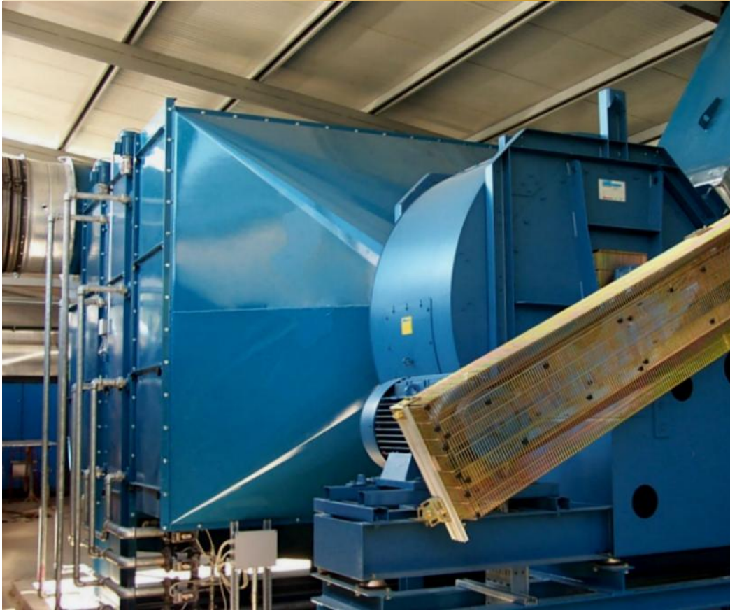
Il depuratore M91 installato presso l'unità produttiva di Olginate della F.lli Mauri.
